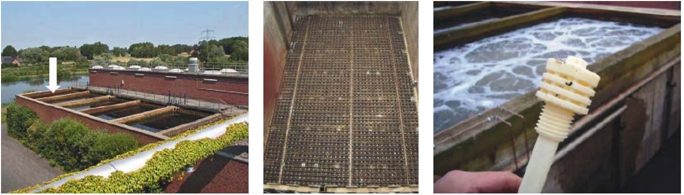
Abb. 3: Biofor-Filtrationsstufe mit der ersten entleerten Filterkammer Nr. 5 (links und Mitte) für den großtechnischen Adsorberbetrieb mit Düsenboden und Düsen (rechts)
